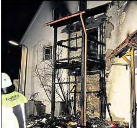
Vollkommen demoliert ist der Balkon an dem Rohrbacher Gebäude in der Bahnhofstraße. Mülltonnen hatten dort Feuer gefangen – die Flammen griffen auf das Haus über. Foto: A. Ermet
