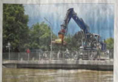
WIE MIT DEM TREIBHOLZ: Mit schwerem Gerät war das THW an der Grenzfelder Imbrücke im Einsatz. Foto: Zivier
