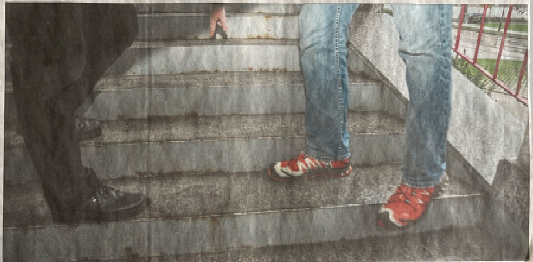
Das war vor zehn Jahren: Schon im November 2014 hatte der Wolnzacher Bauausschuss die Treppe am Wolnzacher Feuerwehrhaus besichtigt und erhebliche Mängel festgestellt. Foto: WZ-Archiv
